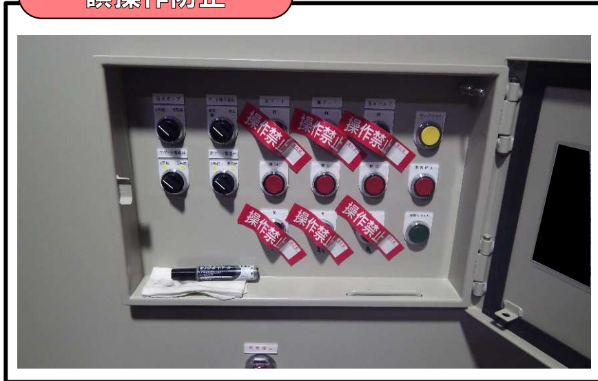
ステッカーによる操作禁止の明示
