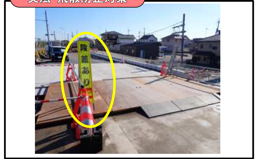
穴あきタイプの工事看板を採用
