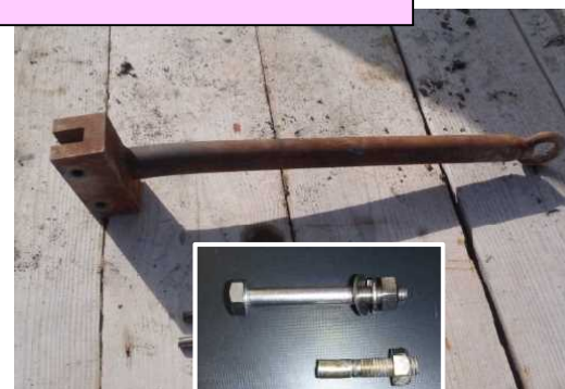
ボルトが破断して飛散
