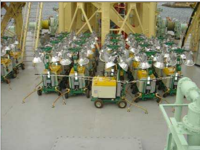
海翔丸甲板に積み込まれた投光機付発電機
